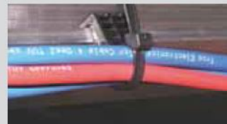
Passage des câbles horizontal
